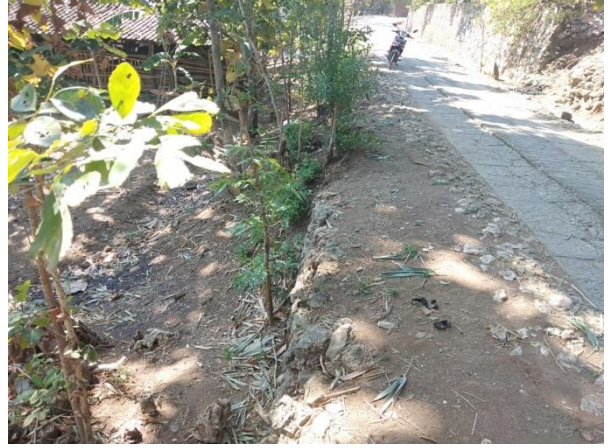
Foto 0% Talud Jalan Dusun Gondang Rt 0001 008
