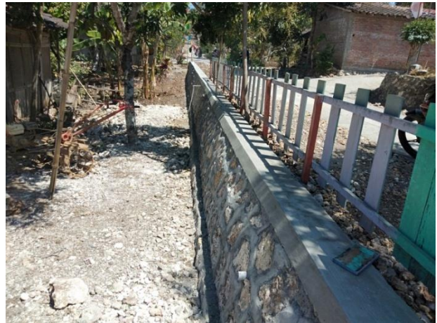
FOTO 0% Talud Jalan Jatiharjo RT 002/06
