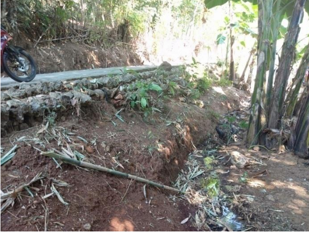
Foto 0% Talud Jalan Dusun Duwet Rt 001/009
